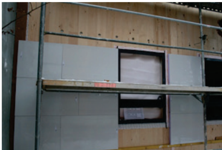
pav. 9: Medžio masyvo sienos vakuuminė izoliacija su fasadine nelaikančiąja siena (šaltinis: Variotec, Neumarkt)
