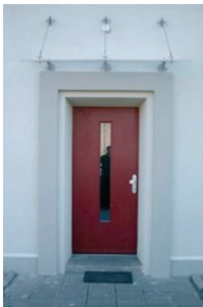
Obr. 19: Dveře vhodné pro pasivní dům (nebo dům s téměř nulovou spotřebou energie), osazené v renovované budově. (zdroj: Schulze Darup)
