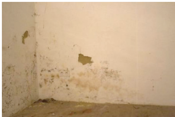
Obr. 20: Rozvoj plísní v rozích, kde působí tepelné mosty (zdroj: GrAT)
