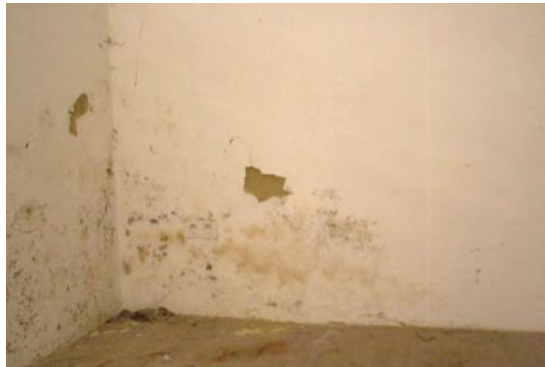
Figura 20: sviluppo di muffe negli angoli per effetto dei ponti termici (fonte GrAT)
