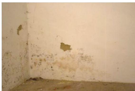
Ilustracja 20: Powstawanie pleśni w narożnikach, gdzie działają mostki termiczne (źródło: GrAT)
