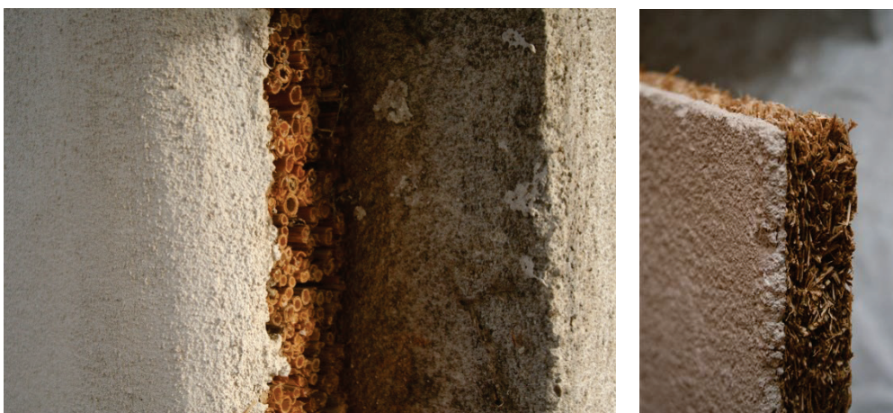
Obr. 21: Vápenná omítka na rákosové desce (vlevo) a na rákosové granulátové desce (vpravo) (zdroj: GrAT)
