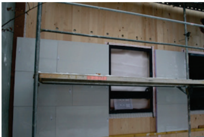
Obr. 9: Vakuová izolace na bezrámové dřevěné stěně; opláštění je zavěšené (zdroj: Variotec, Neumarkt)
