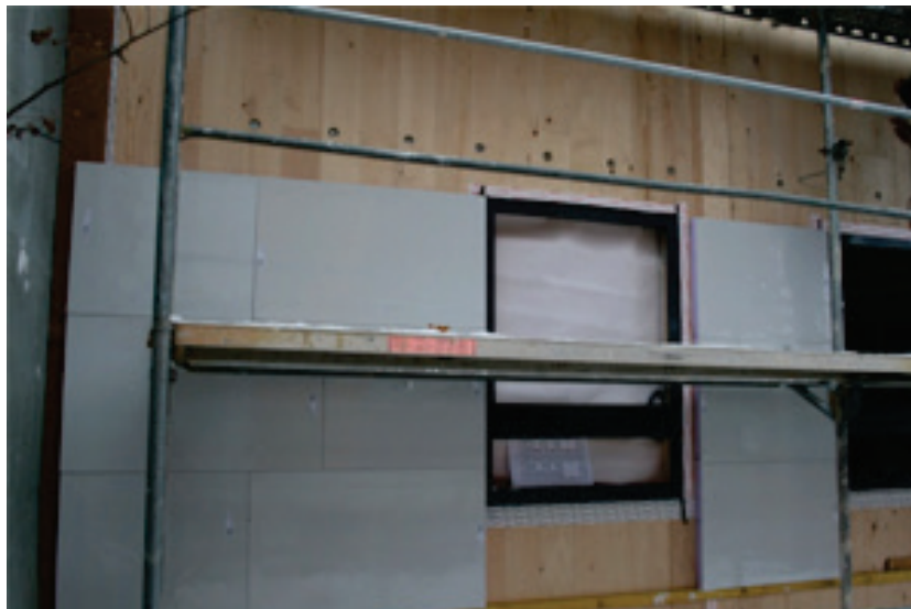
Ilustracja 9: Izolacja próżniowa w bezramowej ścianie wykonanej z drewna; okładzinę zapewnia ściana osłonowa (źródło: (źródło: Variotec, Neumarkt)
