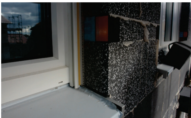
Obr. 2: Izolace ETICS s připraveným místem pro ukotvení sloupku zábradlí. Toto provedení minimalizuje vznik tepelného mostu. (zdroj: Schulze Darup)
