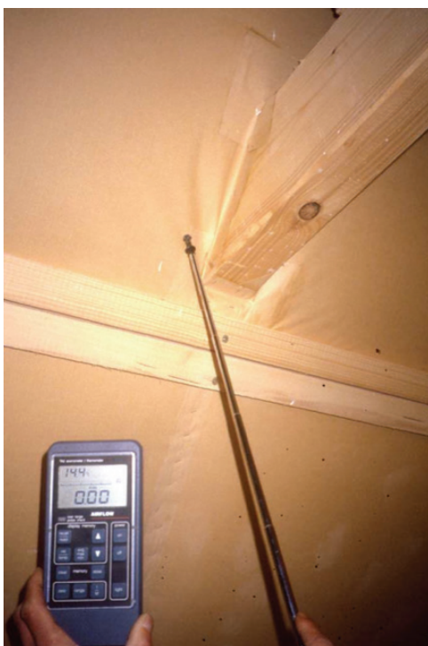
Obr. 24: Měření těsnosti v místech průniku trámu konstrukcí střešního pláště (zdroj: Schulze Darup)
