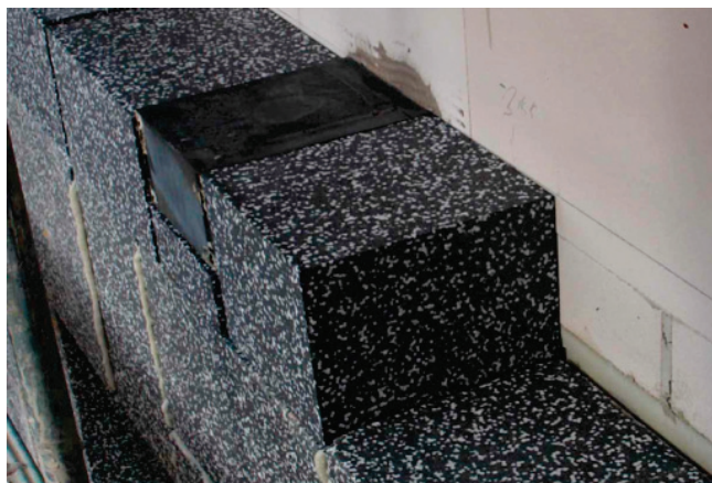
Ilustracja 1: Izolacja ETICS z punktem kotwienia (redukcja mostków termicznych) - światło (źródło: Schulze Darup)
