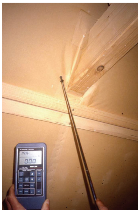
Ilustracja 25: Pomiar nieszczelności dachu (źródło: Schulze Darup)
