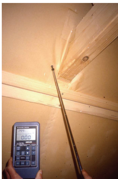
Obr. 9: Měření vzduchotěsnosti v místech průniku trámů konstrukcí střešního pláště. (zdroj: Schulze Darup)
