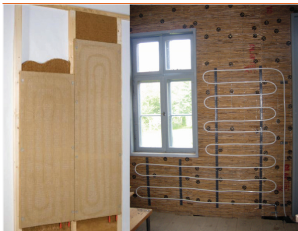
pav. 2 (kairėje). Karkasas, minkštos medžio pluošto termoizoliacinės plokštės, molio šildymo elementai (šaltinis: WEM Wandheizung GmbH)
