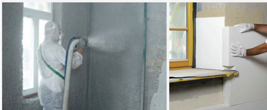
Ilustracja 4 (lewa strona): System izolacji wewnętrznej nakładany przez natryskiwanie celulozy, szczególnie użyteczny dla bardzo nierównych powierzchni (źródło: Isocell GmbH)
