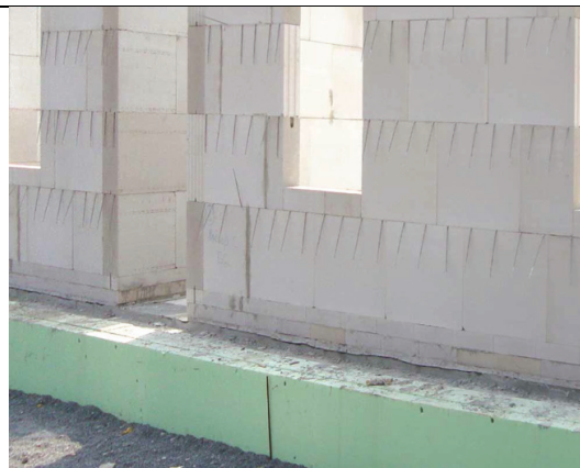
Obr. 12: Vnitřní vrstva zdiva s kotvami pro upevnění vnější líčové vrstvy zdiva (zdroj: Schulze Darup)
