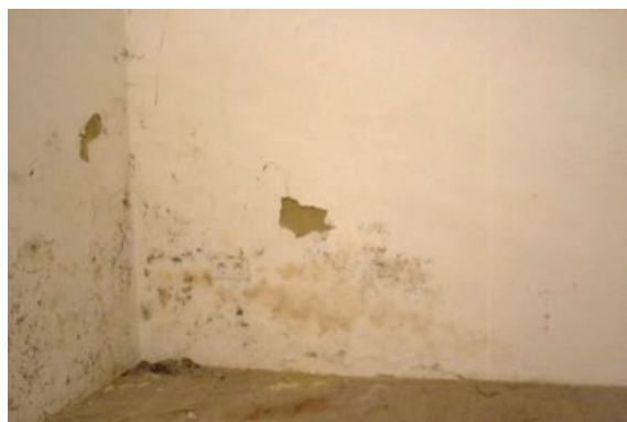
Obr. 18: Plíseň se rozvíjí v rozích, které tvoří tepelné mosty (zdroj: GrAT)
