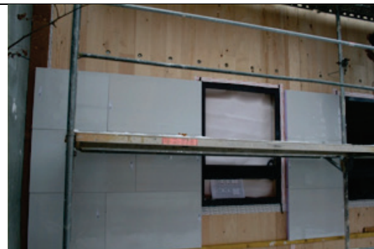
Figura 7: Isolamento sottovuoto su una struttura in legno massiccio; il rivestimento è con facciata continua (fonte: Variotec, Neumarkt)
